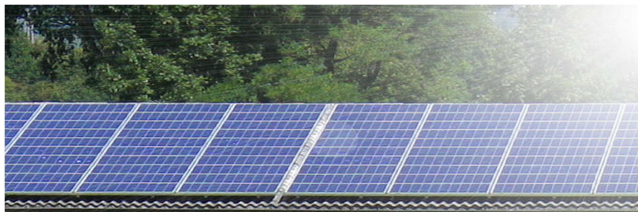
30kW Solarpanel der DKT auf Landwirtschaftsgebäude
